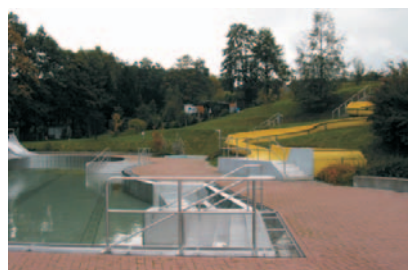
Die Elektronik des Erlebnisbades ist zerstört
