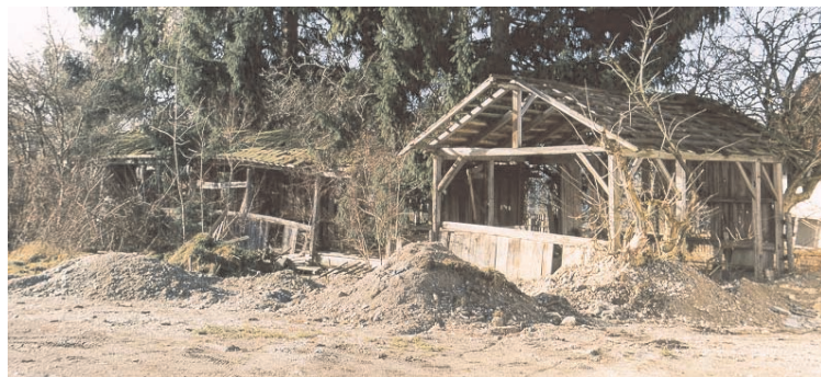
Ein letztes Bild: In Bälde wird nichts mehr von der alten Kegelbahn zu sehen sein!
